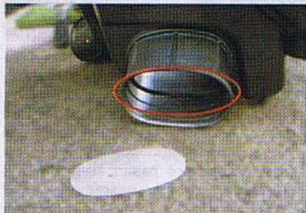
Заглушку вынули (вот она, овальная, лежит), но отливки для ее крепления остались на входе в воздуховод.
